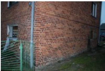
Budynek po wybuchu gazu
